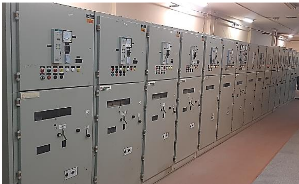
فیدر خط فشار متوسط ۲۰kv
